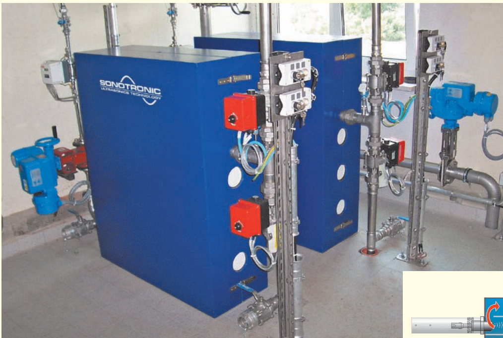
Anlage mit zwei installierten Ultraschallreaktoren
